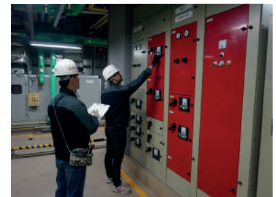
▲ 소방펌프 수동/자동기동 점검
